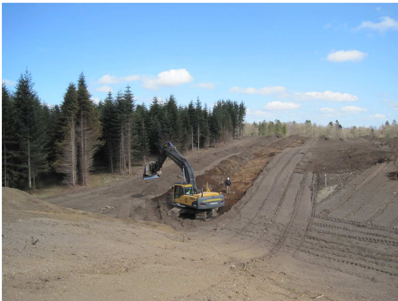
Grøft F 680 under udgravning. Øverst i billedet, til højre for de mørke grantræer, ligger hus A 888. Set fra syd
